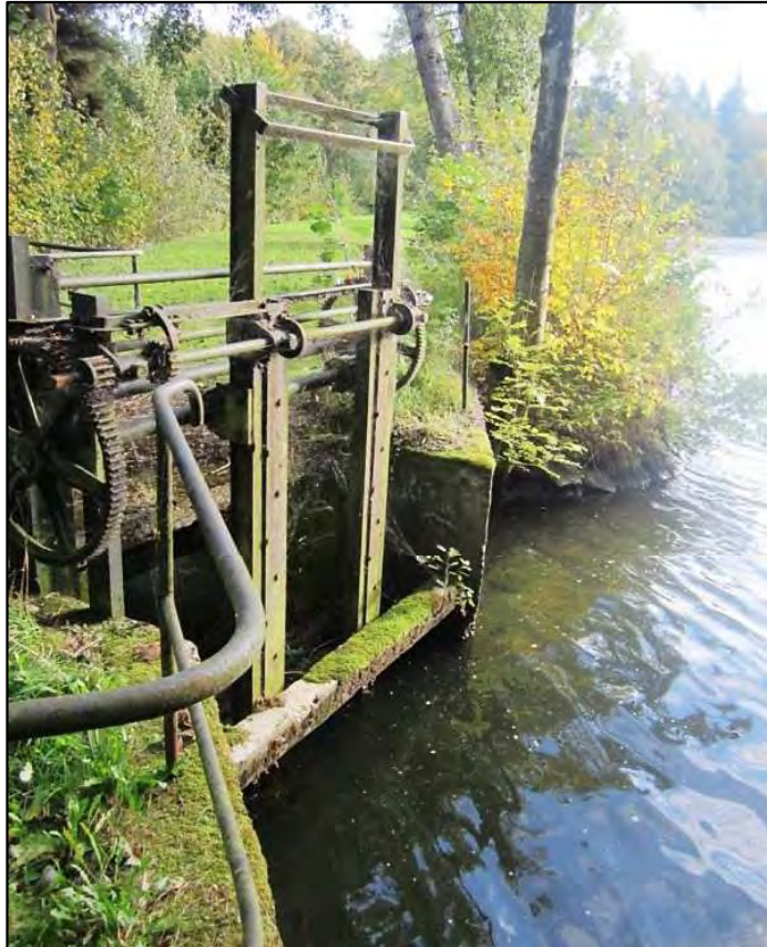
Figur 2-9 Spærring AAR-00331 ved Allinggård Sø udgøres af det stemmeværk, der styrer den mængde vand, der ledes uden om turbinekanalen og dermed ned igennem herregårdsparken.
